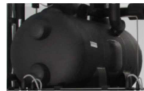
Tanque CO 2 isolado
