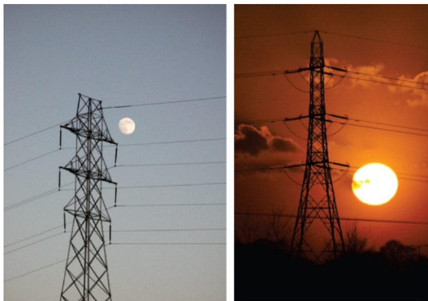
FIGURA 4.1 Detalhe de duas linhas de transmissão de energia elétrica.
