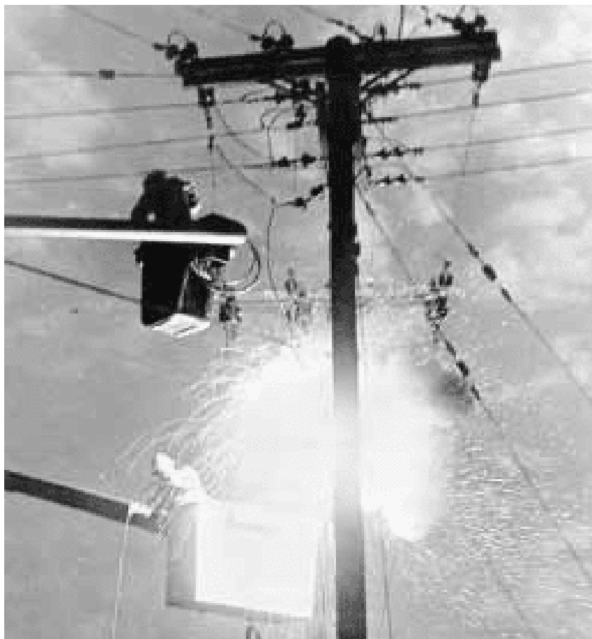
Arco elétrico MT
