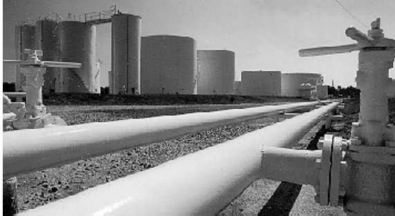
Fig. 1.3. Tubulação para transferência de produtos
