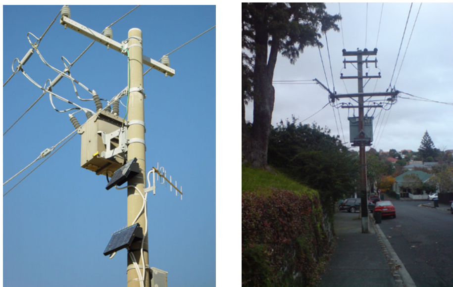
Figura 1.11 – Poste de concreto usado na rede de distribuição urbana.
