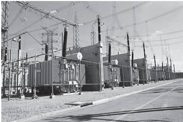
Subestação elevadora. (Cortesia de Furnas Centrais Elétricas.)
