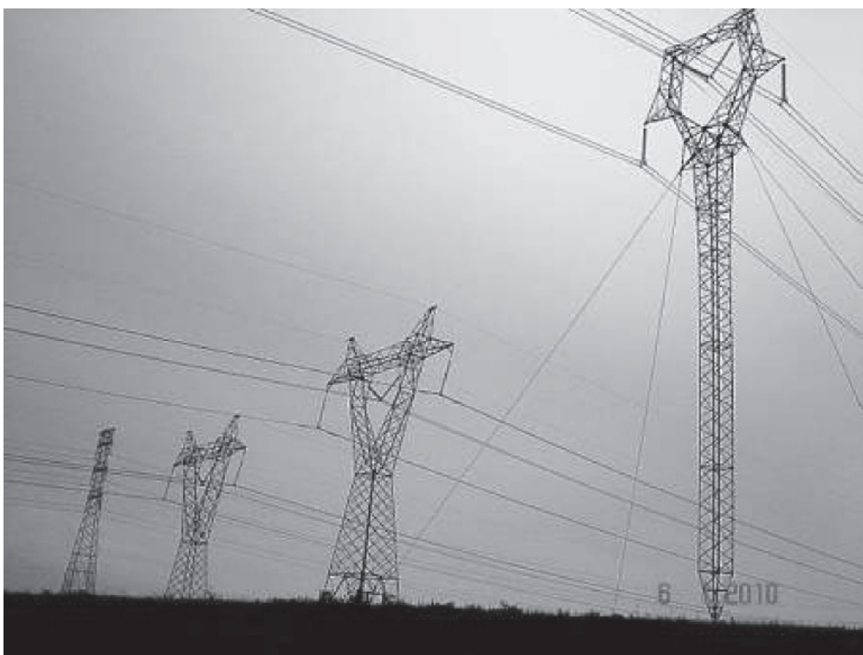
Linha de transmissão. (Cortesia de Furnas Centrais Elétricas.)
