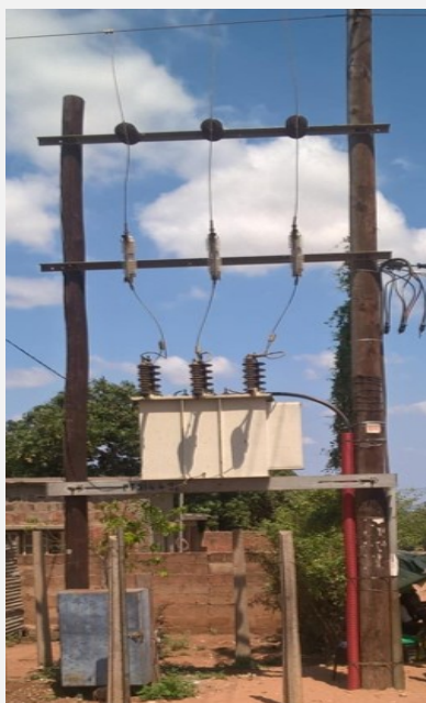
Figura 4.3.4 Posto de transformação tipo M2 Fonte: [Autor]
