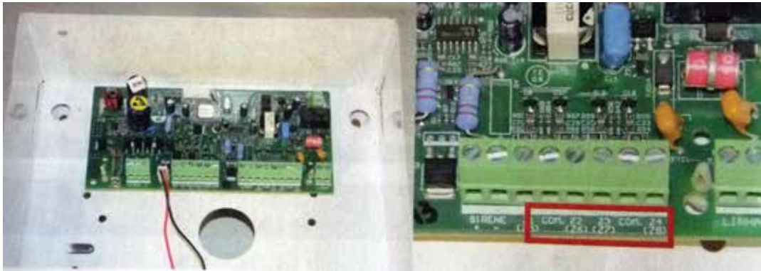
Fig 61 - Interior da central de alarme
