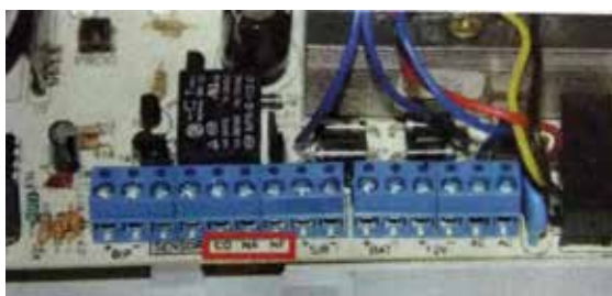
Fig 51a - Habilitando a central de alarme
