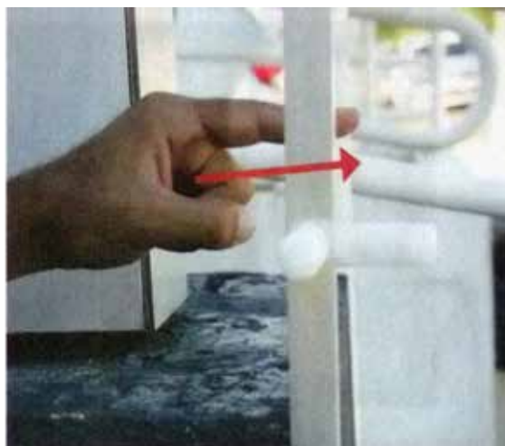
Fig 26b - Direção dos isoladores
