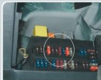
Caixa de relés e fusíveis
