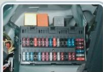
Caixa de fusíveis na central do painel
