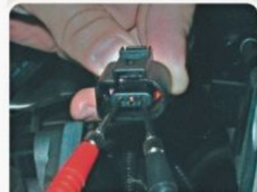
F.2.1 - Procedimento de medida da tensão de alimentação do sensor CMP.
