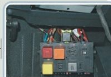
Caixa de relés, localizada acima dos fusíveis
