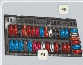
Fusíveis de proteção dos relés do eletroventilador, ambos de 40A.
