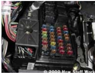
Painel de fusíveis no interior
