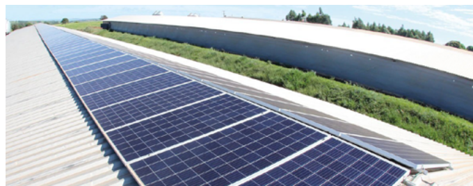
Figura 24 - SFV em telhado metálico. Fonte: CNA Brasil/2022.
