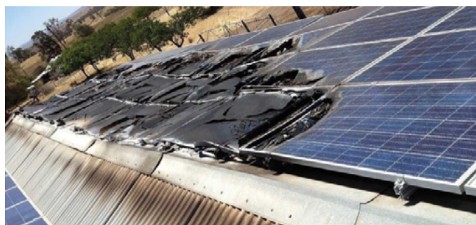
Figura 5 - Dano típico do impacto direto do raio no sistema fotovoltaico (SFV).
