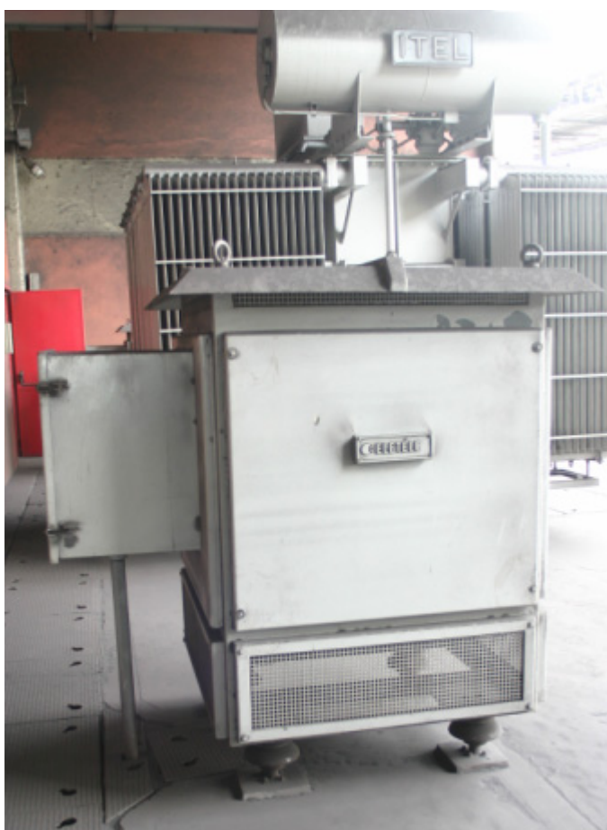
Fig 66 Resistor de aterramento do centro da estrela do transformador
