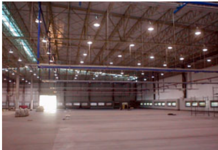
Fig 75 Iluminação de um galpão industrial
