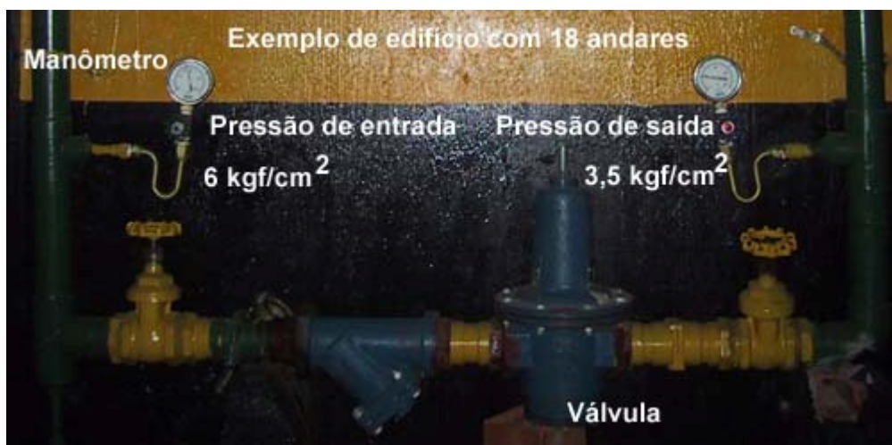
Foto 1 - Válvula redutora de pressão situada no sub-solo de um edifício de 18 andares
