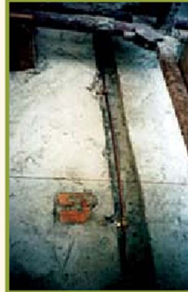
Descida com cabo de cobre embutida no reboco
