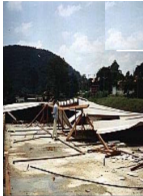
Descarga direta destruiu 30 metros de um telhado e lançou telhas a 80 metros
