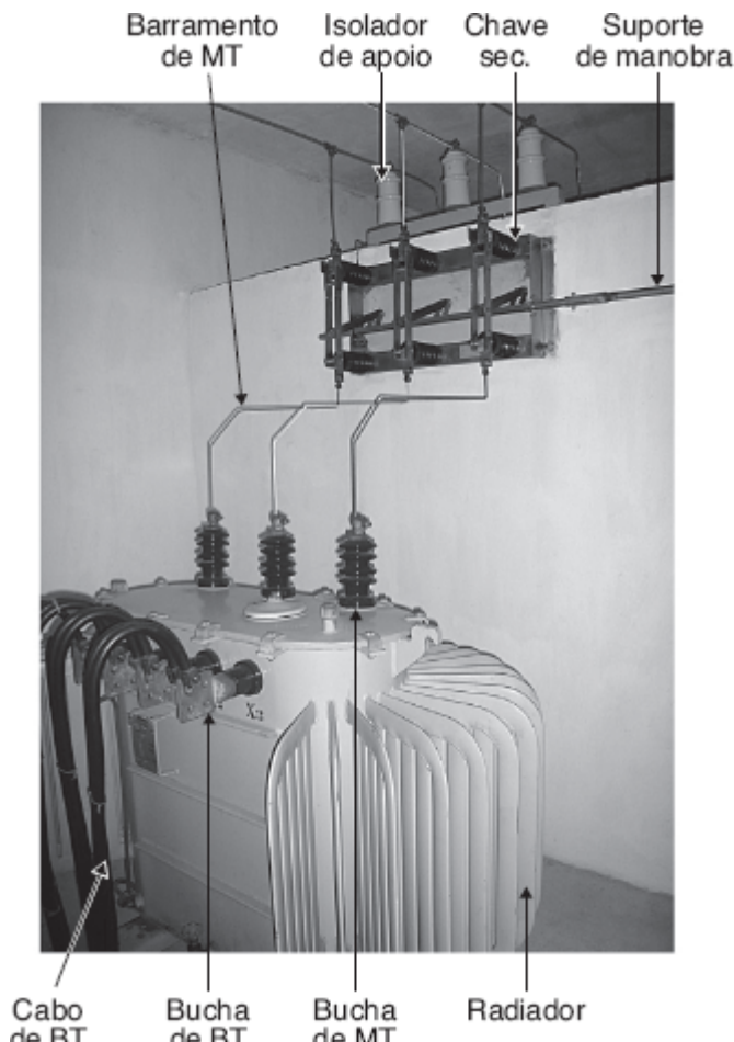
Figura 12.7 Cubículo de transformação de uma subestação em alvenaria.
