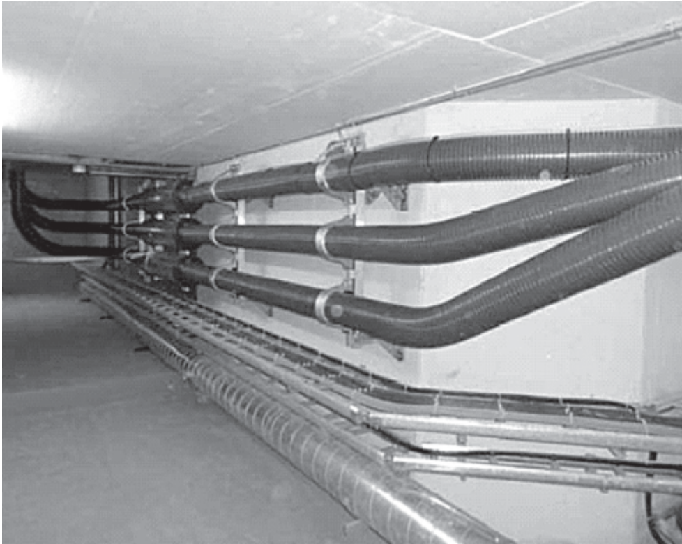
Figura 3.46 Túneis de serviço de utilidades.
