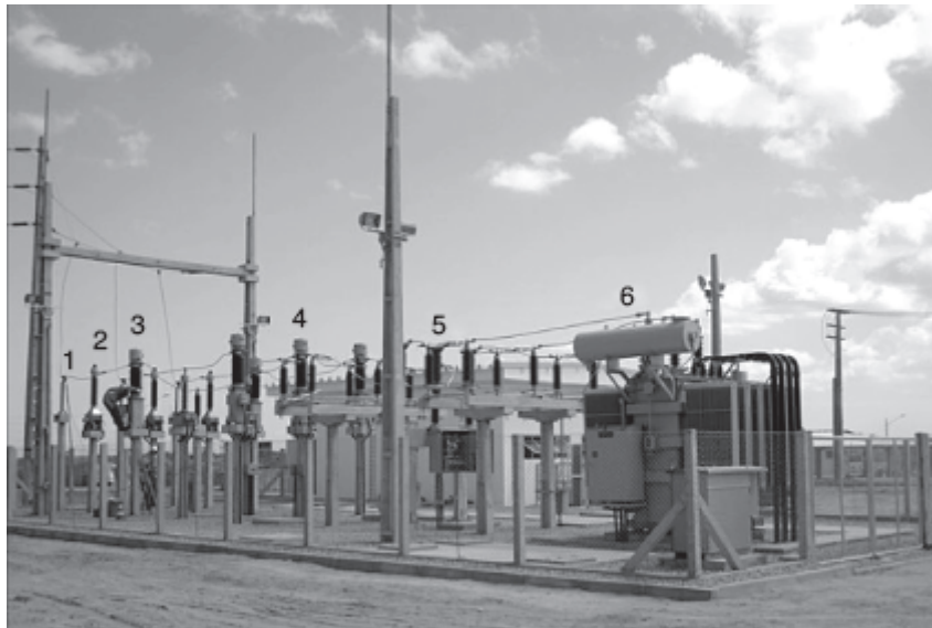
1 - Para-raios; 2 - Transformador de potencial; 3 - Transformador de corrente; 4 - Disjuntor tripolar; 5 - Chave seccionadora; 6 - Transformador de potência
