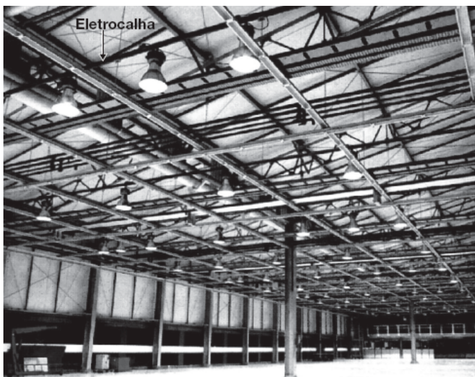
Figura 2.28 Iluminação de um galpão industrial com projetores.
