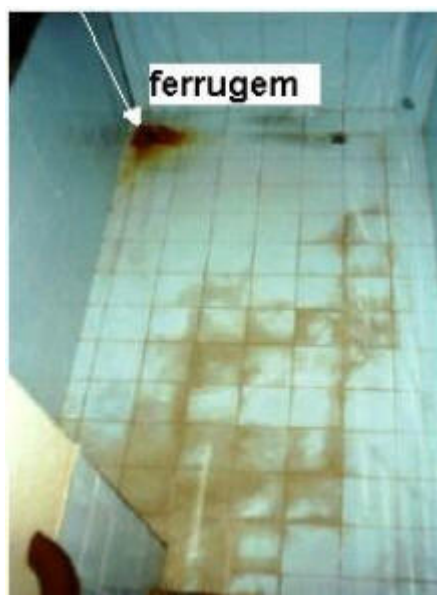
Figura 5. Ferrugem e manchas.
