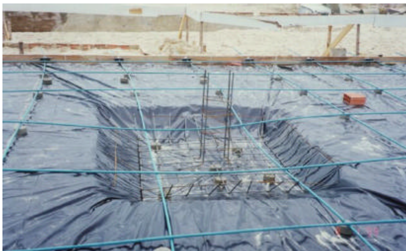
Radier pronto para concretagem, vendo-se capitel sob pilar, e bolachas de concreto para suporte das cordoalhas.
