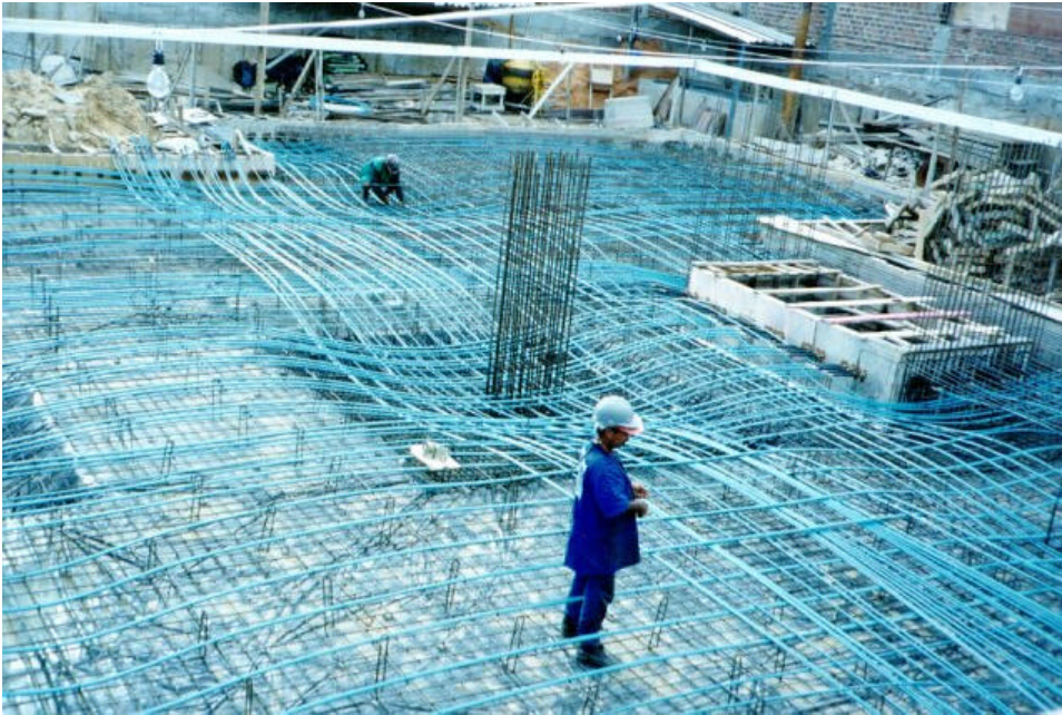
Montagem das cordoalhas na laje, vendo-se os capitéis sob os pilares. Foram usadas 3 ton. de cordoalhas, em laje de aprox. 300 m 2 .
