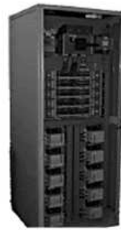
Banco de capacitores automático
