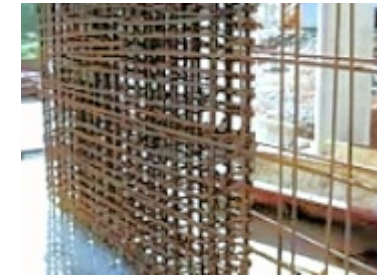
Estrutura densamente armada
