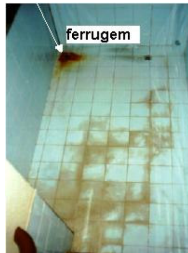
Figura 5. Ferrugem e manchas.
