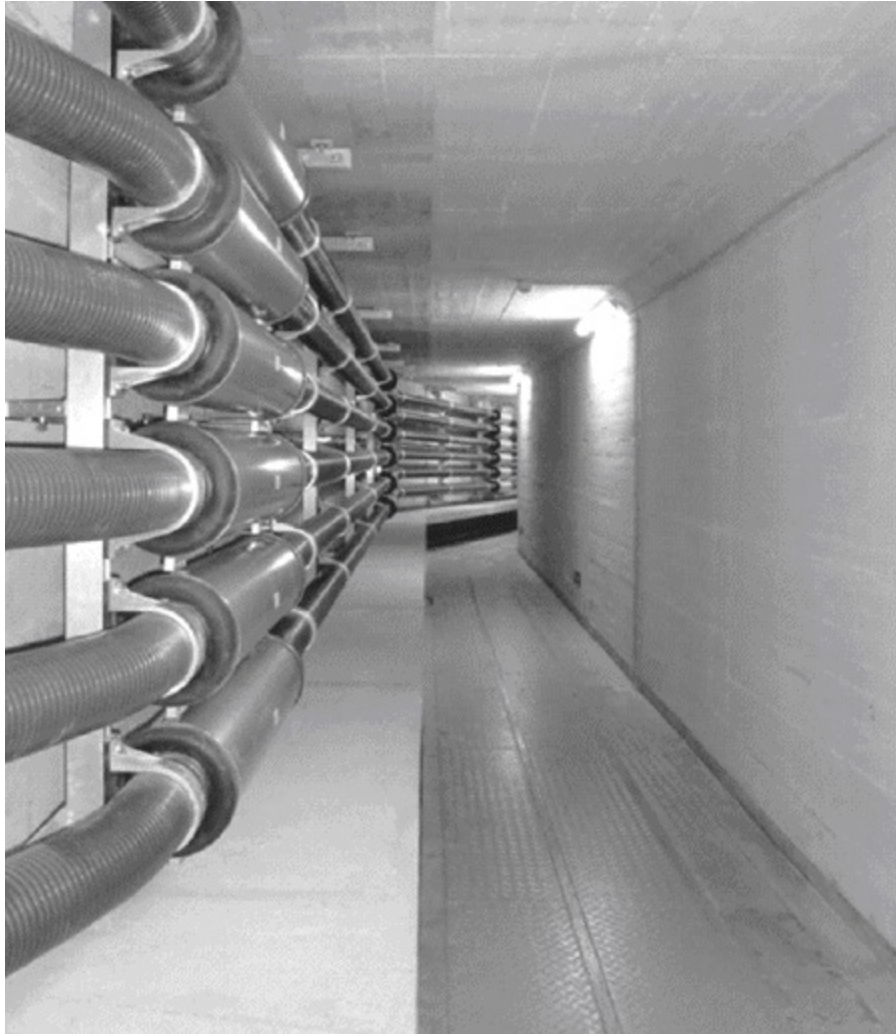
Figura 3.45 Túneis de serviço para cabos; instalação em suportes verticais.
