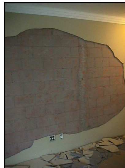
Trinca e posterior queda de revestimento interno – deformação excessiva da estrutura
