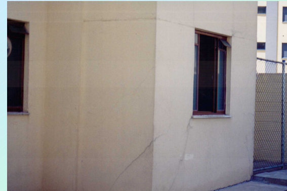
Trinca em revestimento externo – deformação excessiva da estrutura do primeiro pavimento sobre pilotis / ausência de contra-verga...
