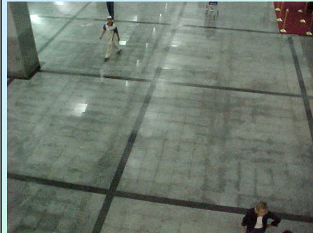
Manchamento por umidade
