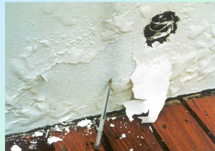
Perda de aderência da camada decorativa: pintura
