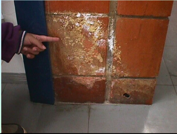
Manchamento por eflorescência
