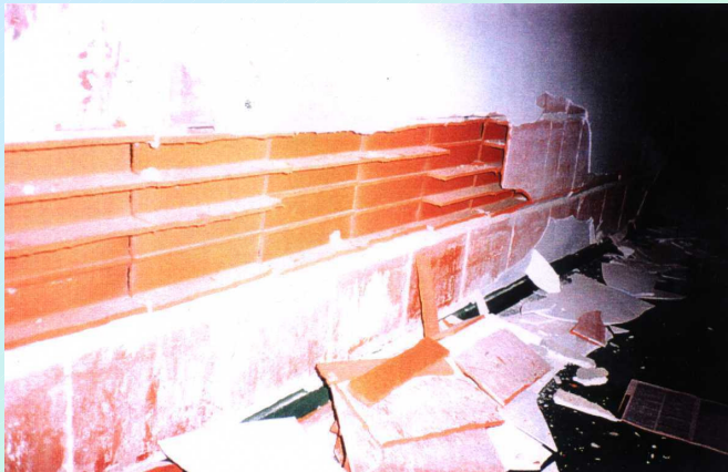
Trinca com queda de revestimento interno – deformação excessiva da estrutura e ruptura da alvenaria de vedação
