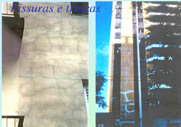
Fissuras de retração em revestimento de argamassa de fachada
