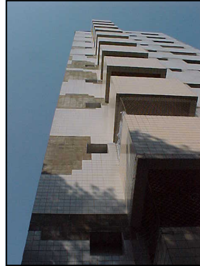
Placas cerâmicas que se destacam do emboço que permanece completamente aderido. Ed. Em São Paulo
