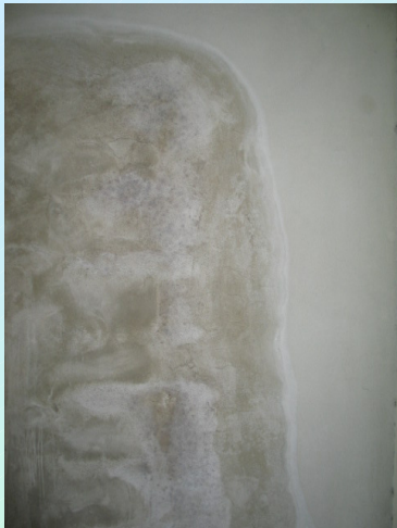
UMIDADE INTERNA POR PENETRAÇÃO DE ÁGUA PELA FACHADA
