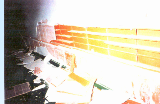
Revestimento interno não suporta a deformação intensa da base
